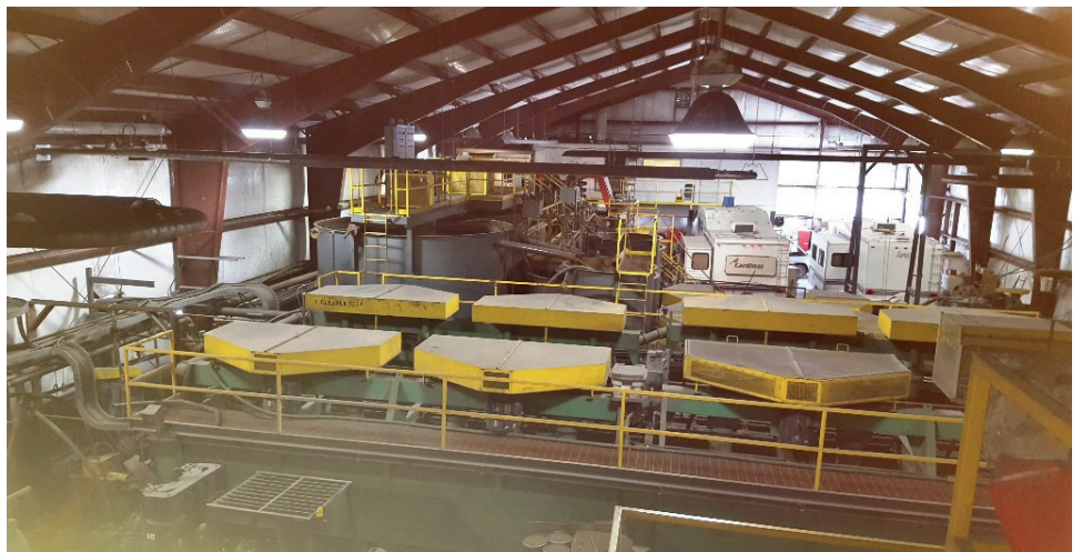
Die moderne Flotationsanlage kann Gold-Doré-Barren und Kupfer-Gold-Konzentrate produzieren (zum Verkauf an eine Schmelzerei). Die Anlage war 2008 nur für kurze Zeit in Betrieb; aufgrund zu niedrigen Goldpreisen von damals etwa $750/Unze (die PEA-Studie vom Juni 2016 PEA kalkulierte Produktionskosten ("all-in production costs") i.H.v. $820 USD/Unze).
